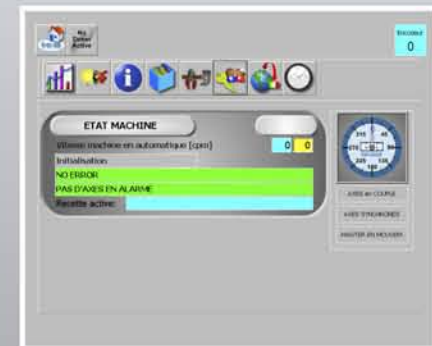
Siemens SIMATIC S7 PLC avec terminal touchscreen OPI
